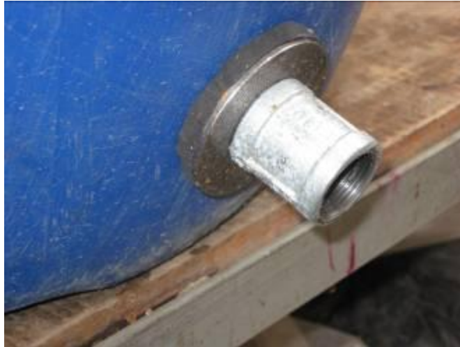
Tanque interior de agua caliente: entrada de agua fría (afuera del tanque.)
