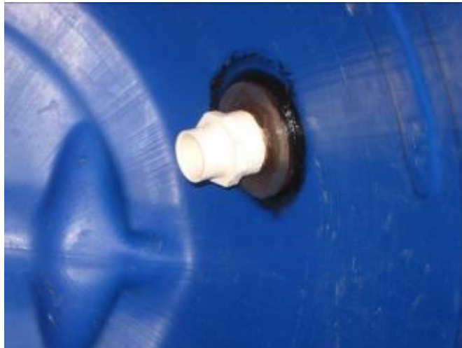
Tanque interior de agua caliente: entrada de agua fría (adentro del tanque.)
